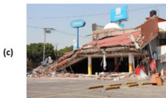
Planta baja débil. (a) Estructura con planta baja débil con muros ligados a las columnas; (b) edificio con el mismo uso que elimina el problema de planta baja débil; (c) colapso de un edificio con planta baja débil. Elaboración propia de autores.
